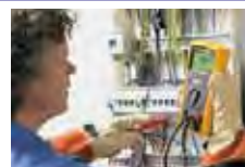
Comprobación de aislamiento en un cuadro de distribución
